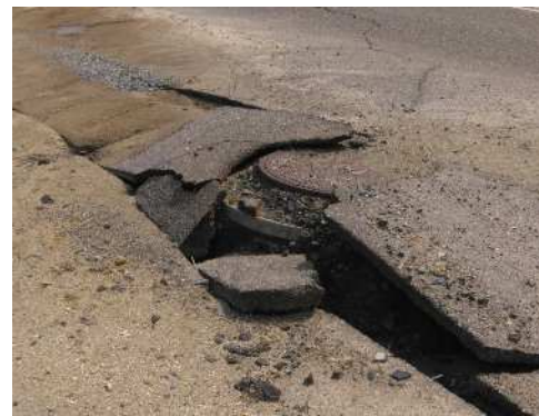
液状化によるMHの被災例
