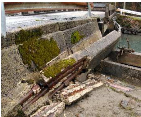
橋梁添架管路の被災例
