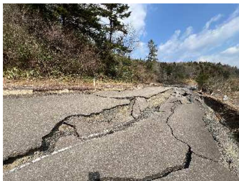
管路ルートへの被害
