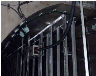
既存接続BOX
