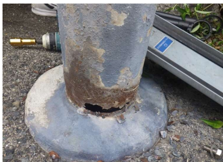
老朽劣化した鋼管柱の地際部
