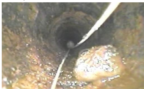
管内の腐食状況
